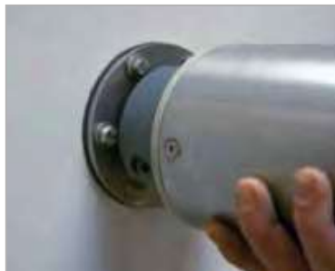
Laat de buis zakken over het U-profiel. LET OP! Blijf de kabel ook doorvoeren zodat deze niet beschadigt.
